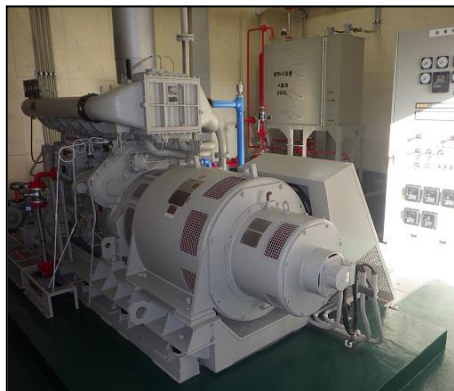
非常用自家発電設備（東金配水場）
