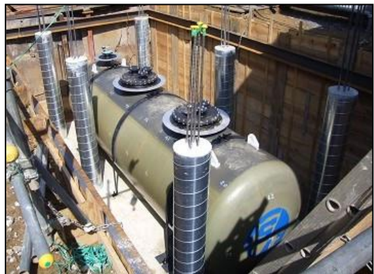
地下燃料タンク（東金配水場）
