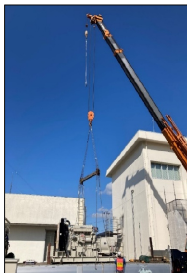
非常用自家発電設備の更新 （令和3年度）
