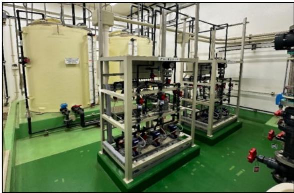
次亜塩素酸ナトリウム注入設備
