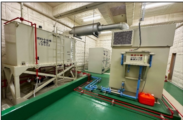
非常用自家発電設備
