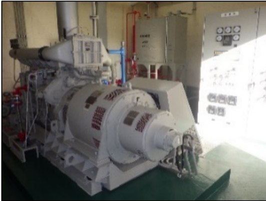
東金配水場（令和 3 年度更新）
