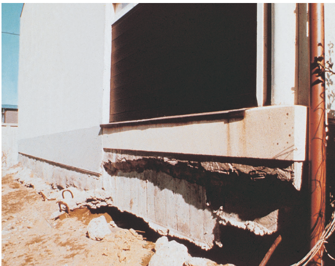
まわりの地盤が沈下して、建物の基礎があらわれた (1973(昭和48)年 浦安市)
