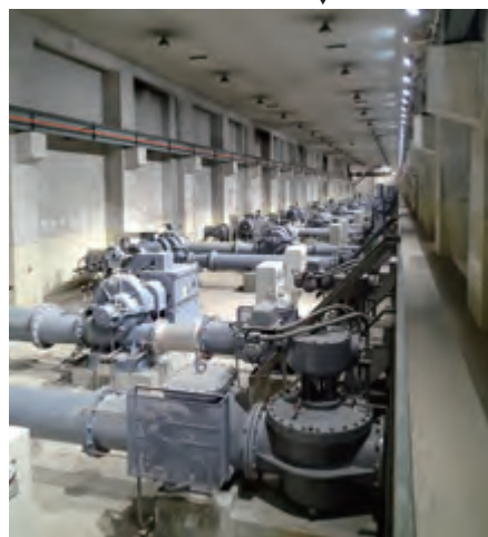
そうすい かしわい じょうすいじょう ●送水ポンプ (柏井浄水場)
