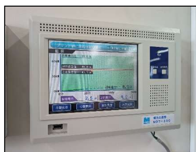
②⑩デマンド監視装置
