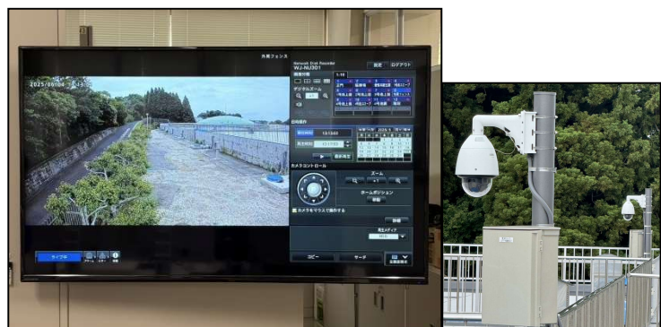
③監視カメラ設備
