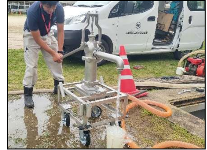
⑫耐震性貯水槽の使用方法的確認
