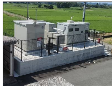
⑫事務局庁舎非常用自家発電設備
